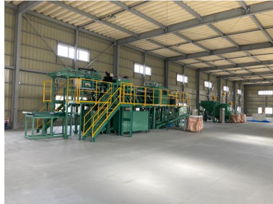
■ 太陽光パネルのリサイクル施設(屋内)
